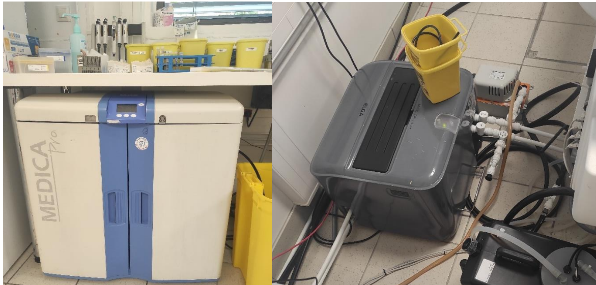
Figure 22 : Solution de traitement d'eau au laboratoire du CHAC (à gauche l'osmoseur et à droite les effluents)
